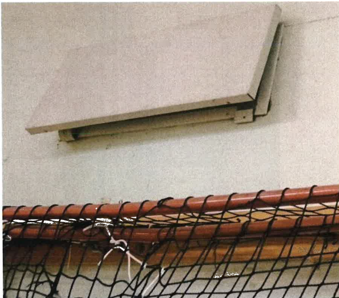
Figur 6. Överluftsdon på loft i gymnastiksal är något skadade
