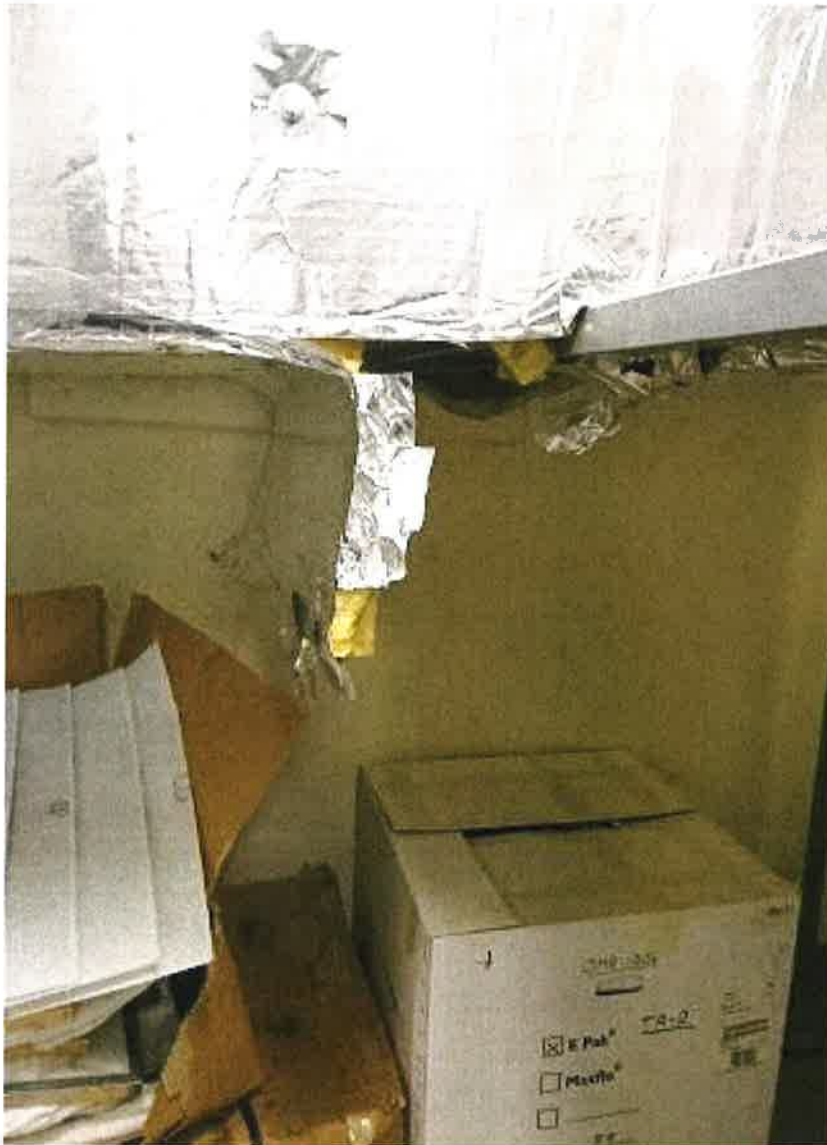
Figur 16. Kondensisolering som släppt från kanal.
