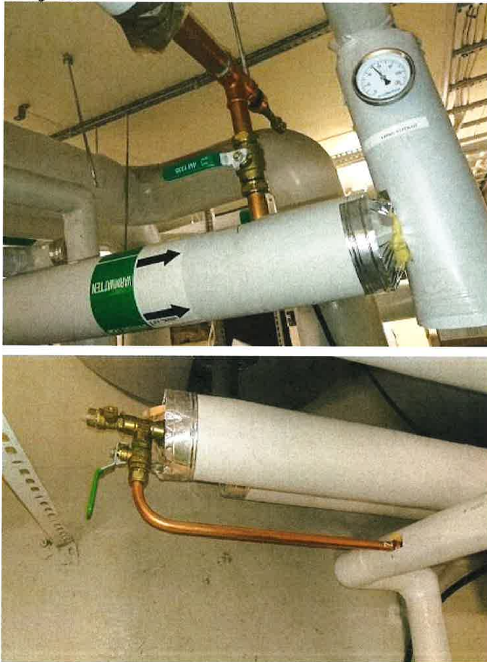
Figur 12. Oisolerade rör i undercentral
