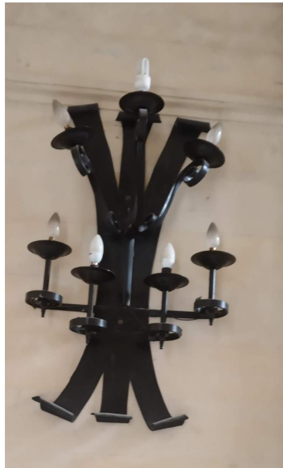
Εικόνα 3δ: Επίτοιχο φωτιστικό με λαμπτήρες LED στη σκάλα του κτηρίου.
