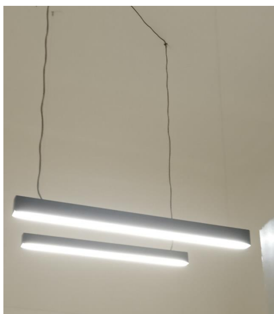
Εικόνα 3η: Φωτιστικά φθορισμού οροφής σε διάφορους χώρους του κτηρίου.
