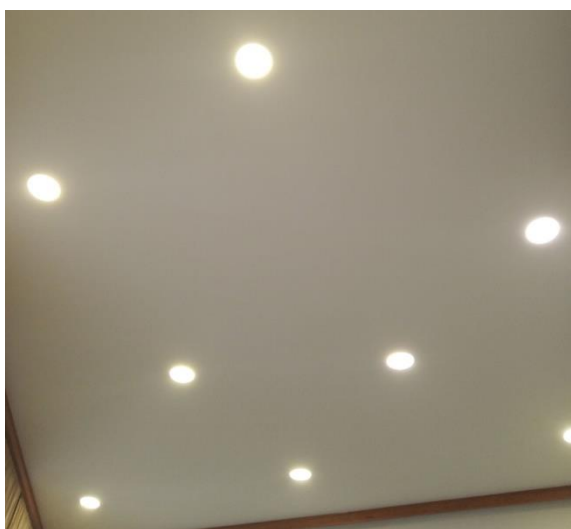
Εικόνα 3ζ: Χωνευτά φωτιστικά με λαμπτήρες LEDστο γραφείο του Δημάρχου.
