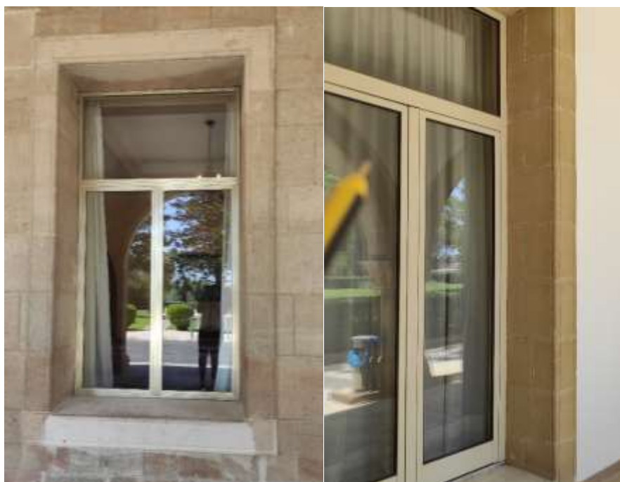
Εικόνα 4: Αριστερά: Κουφώμα παλαιού τύπου με πλαίσιο αλουμινίου χωρίς θερμοδιακοπή και μονό υαλοπίνακα. Δεξιά: νεότερο κουφώμα με πλαίσιο αλουμινίου χωρίς θερμοδιακοπή και διπλό υαλοπίνακα
