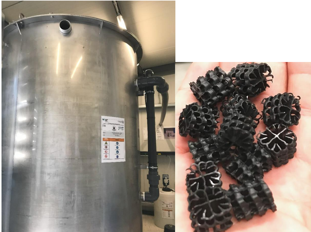
Εικόνα 22: Μονάδα Αερόβιας Επεξεργασίας MBBR, πλαστικοί βιοφορείς (πληρωτικό υλικό)
