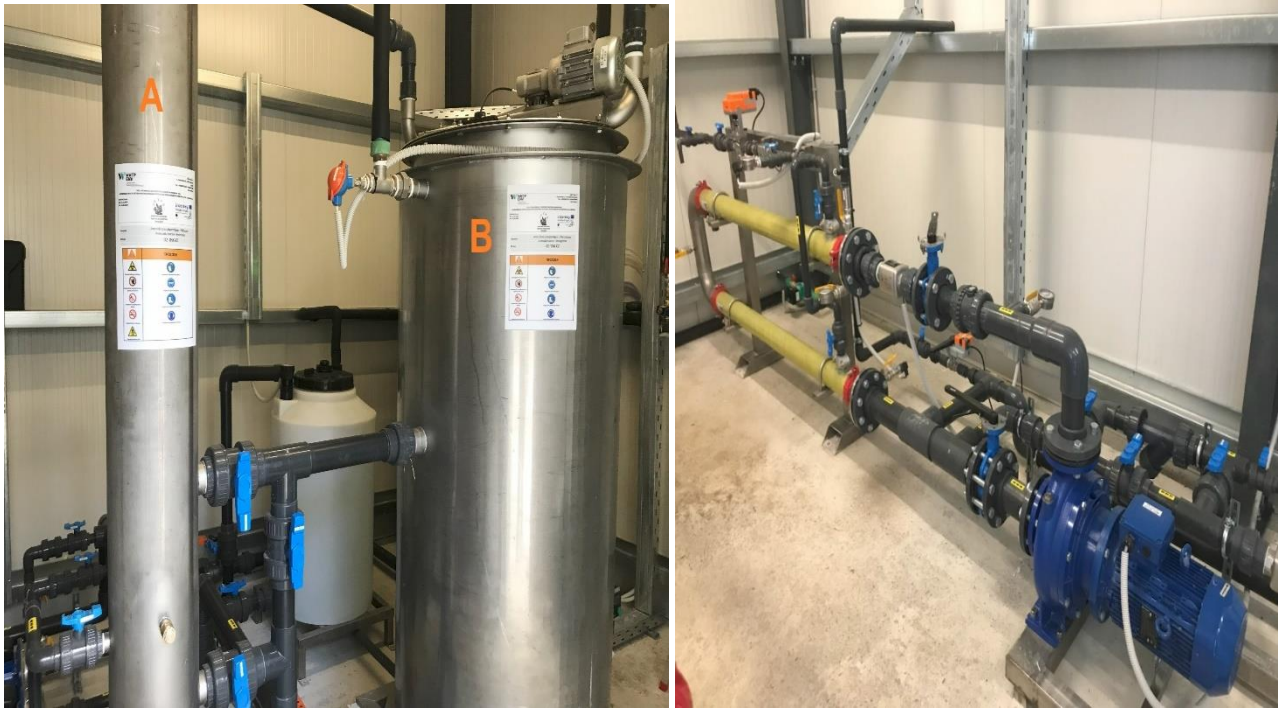
Εικόνα 11: Μονάδα Αναερόβιας Επεξεργασίας AnMBBR, Αντιδραστήρα υδρόλυσης – οξυκογένεσης και σύστημα μεμβρανών
