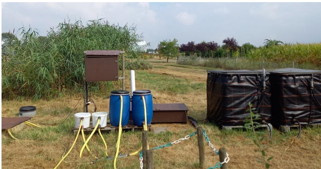
Foto 1: Filtersystemen op het PCS om fosfor te verwijderen
