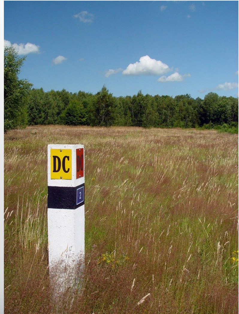
Marker kabla SwePol Link © Tomasz Ciemnoczulowski
