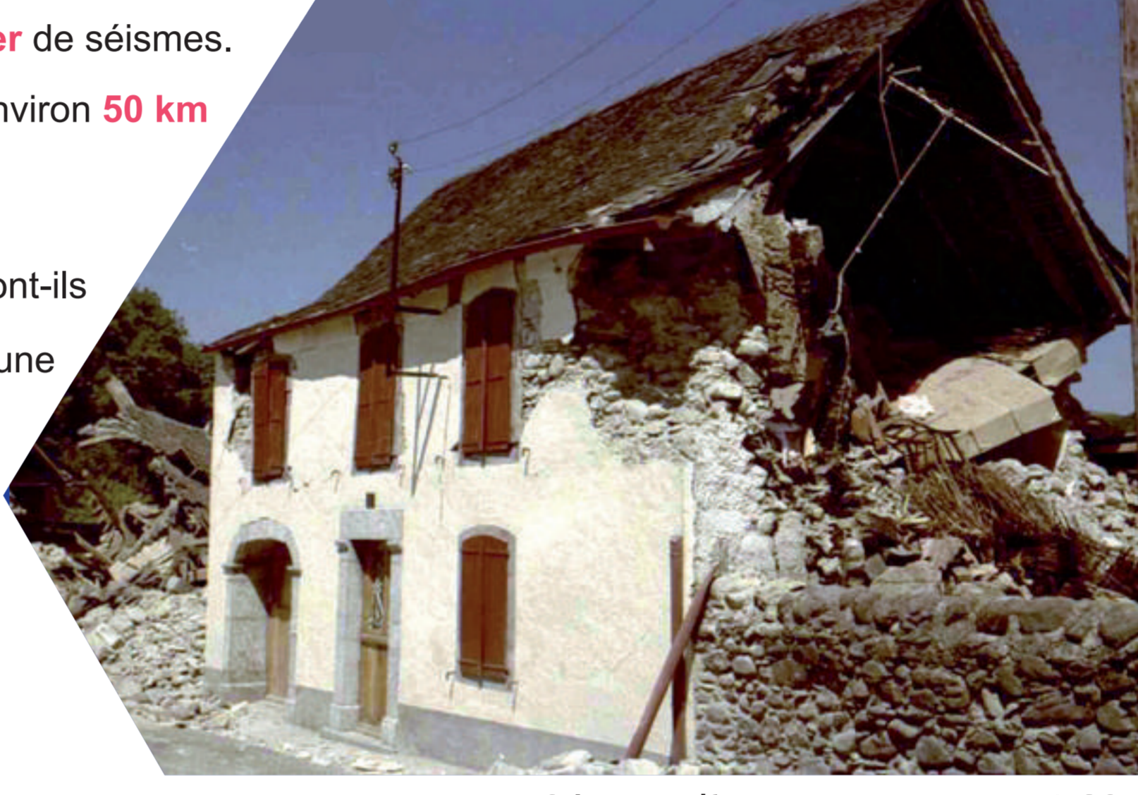
Séisme d'Arrette en 1967 - @BCSF
