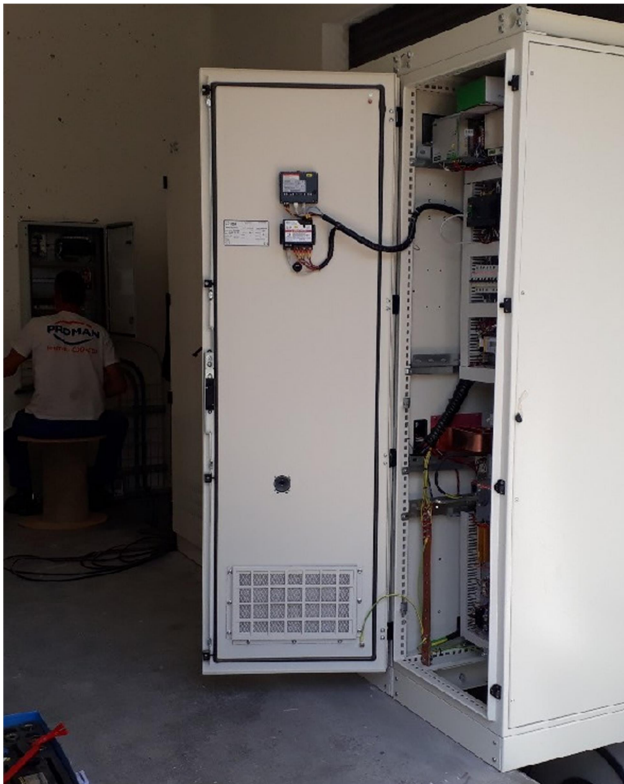
Armarios eléctricos en el local carga
