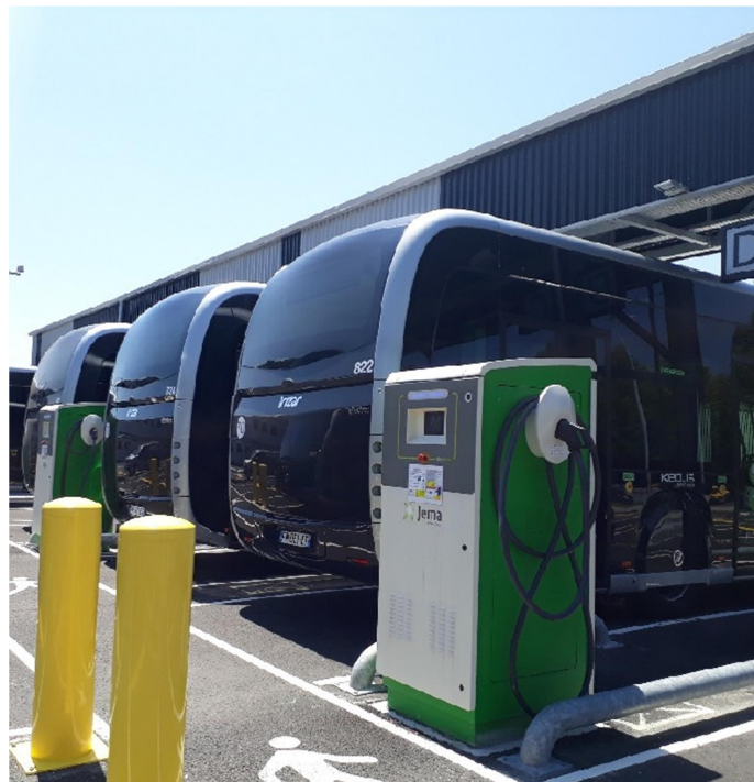
Cargadores dobles 2 x 50 kW
