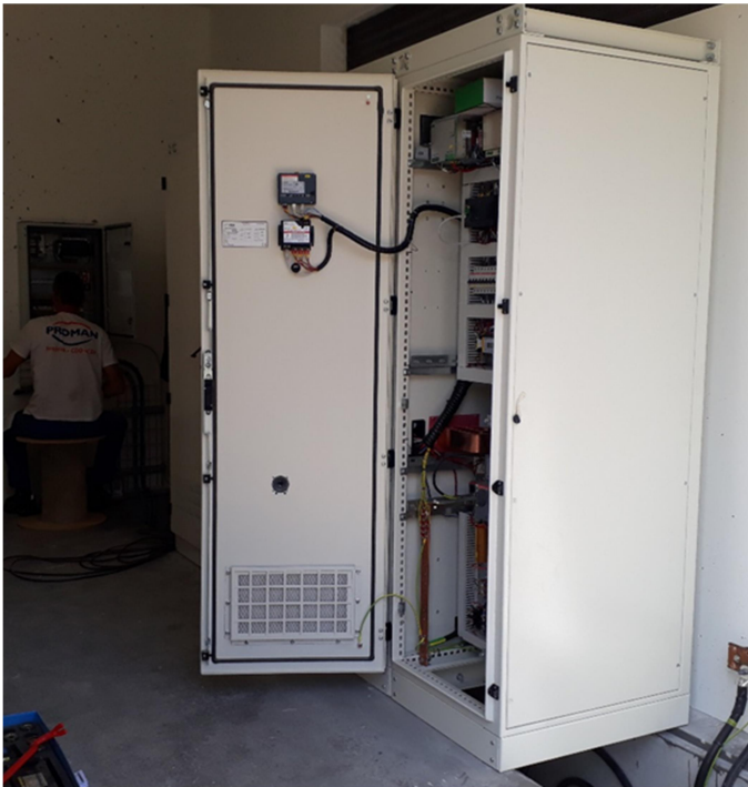
CABLAGE DES ARMOIRES ELECTRIQUES DU LOCAL DE CHARGE DE HAUTS DE BAYONNE
