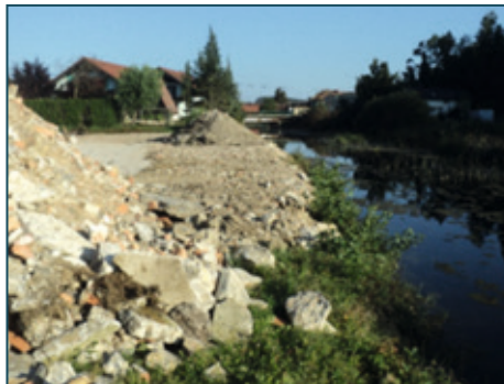
Nedovoljeno nasipavanje na brežini vodotokov
