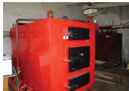
2.5. ATTĒLS: Katlu mājas Sila ielā, Zasas ciemā jaunais malkas katls
