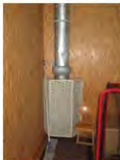
2.16. ATTĒLS: Zasas vidusskolas sporta zāle. Sporta zāle tiek apkurināta izmantojot dīzeļdegvielas katlu. Siltumu zālē nodrošina gaisa pūtējs (attēlā apakšā), palīgtelpās - radiatori
